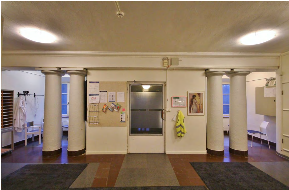
Vy mot trapphus och sekundär vägg flankerad av släta putsade kolonner som bär upp en balk, bakom dessa finns fönster mot gården (norr). Samtliga delar är original utom vägg mot trapphus.
