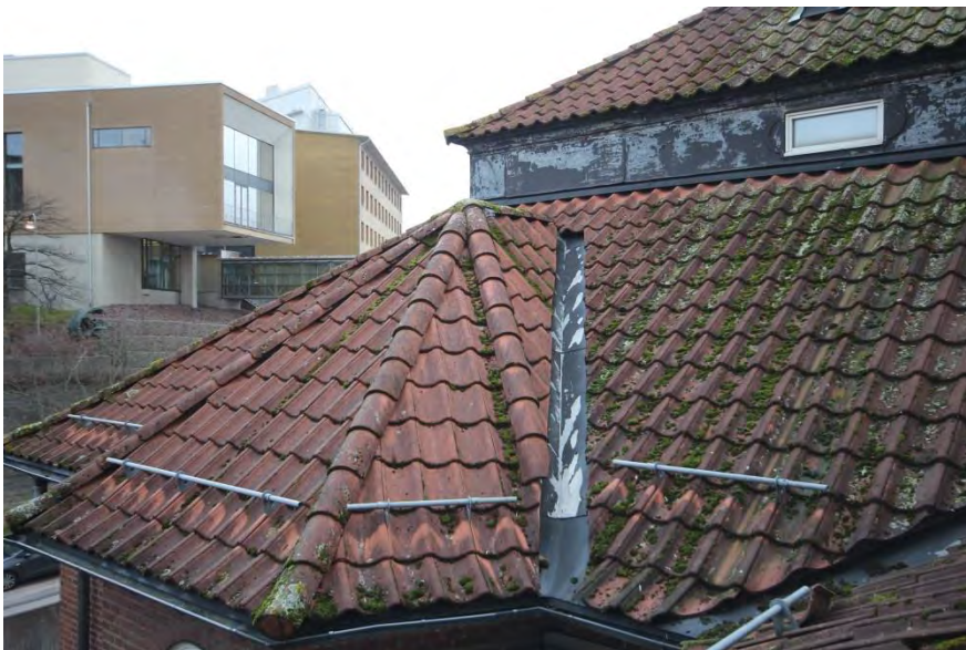
Taktegel med påväxt och plåtdetaljer med färgsläpp.
