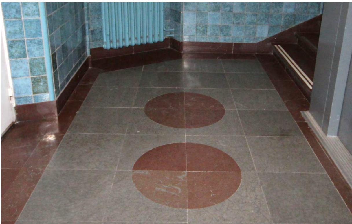
Plan 5. Kalkstensgolv i grå kalksten med fris och sockel samt intarsia i röd kalksten. Plan 5 ett mönster i form av tre ringar medan plan 3-4 har mönster i form av medaljonger.
