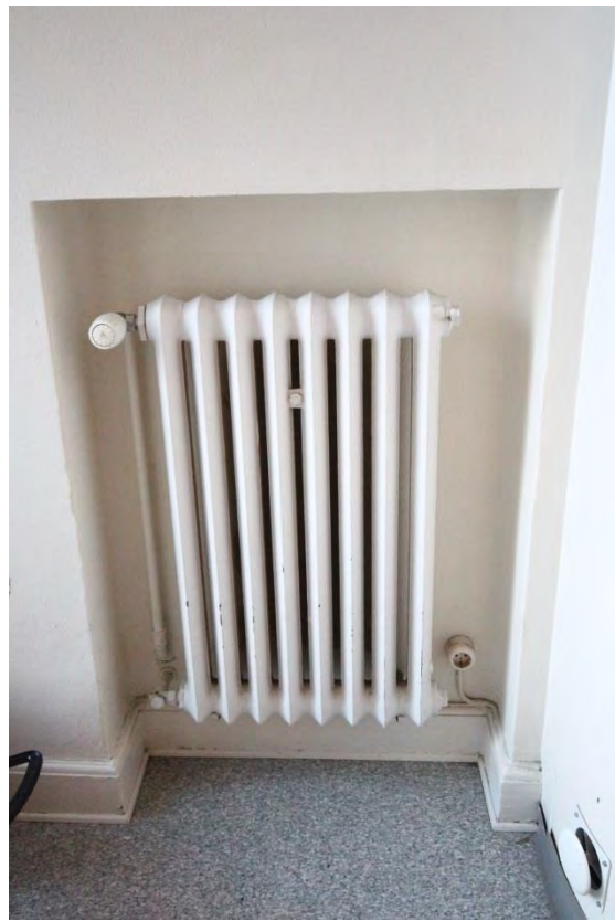
Nisch, sockel och radiator – original.
