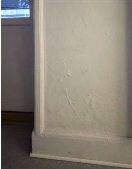
Fuktgenomslag, yttervägg mot söder, plan 4 i rum 422.
