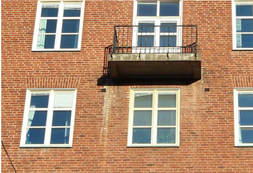
Rinningar i fasaden till följd av bristfällig avvattning från balkongen.
