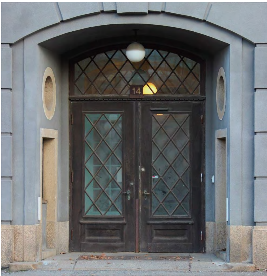
Entréparti i ek med nedslitet ytskikt och torrspäckor till följd av eftersatt underhåll.
