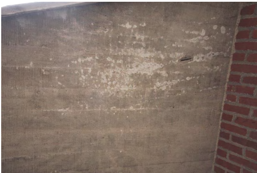
Rostande, frilagt armeringsjärn på undersida av balkongplatta.
