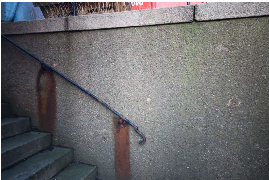
Rostande smidesräcke med rostutfällningar till följd av eftersatt underhåll.
