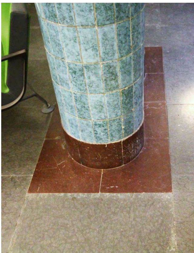
Rum 00.003a. Fris och sockel i röd kalksten samt kakelsbröstning på kolonn.
