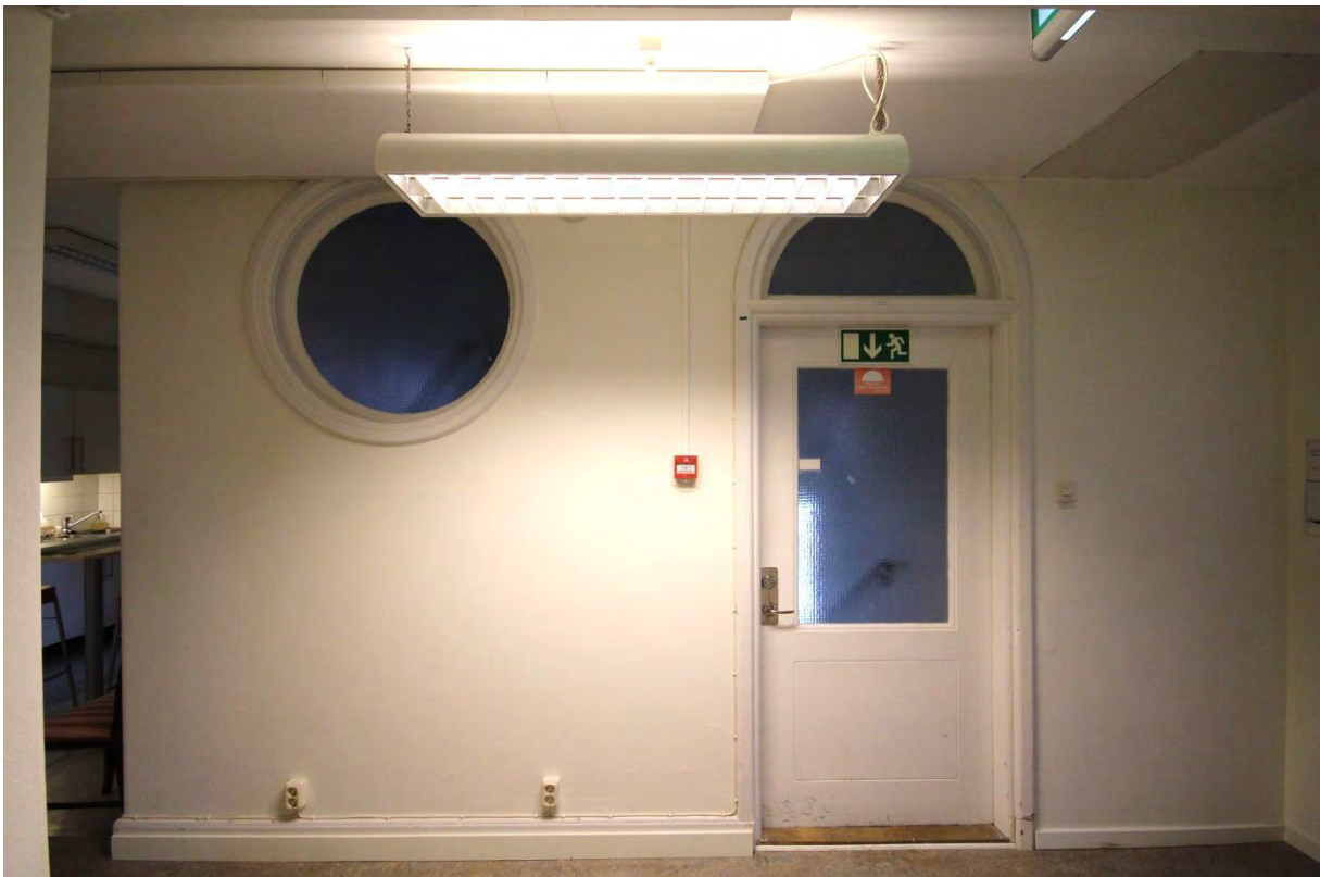
Rum 05.531. Vy mot gårdstrapphuset. Sockel, foder, dörr- och fönsteromfattning är original. Dörr och fönsterglas är utbytta.
