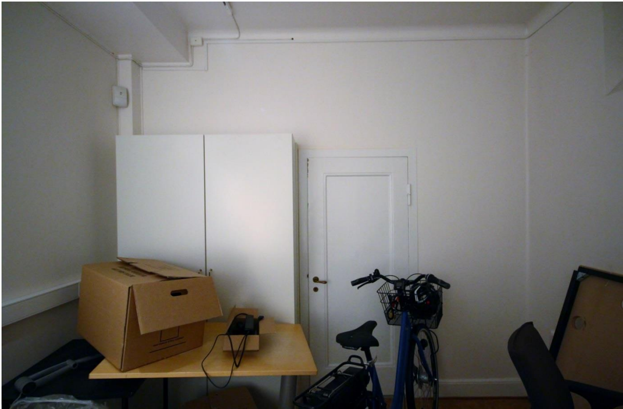
Rum 02.208 är ett originalrum med bevarade detaljer i form av sockel, dörr och foder. Taket är putsat.
