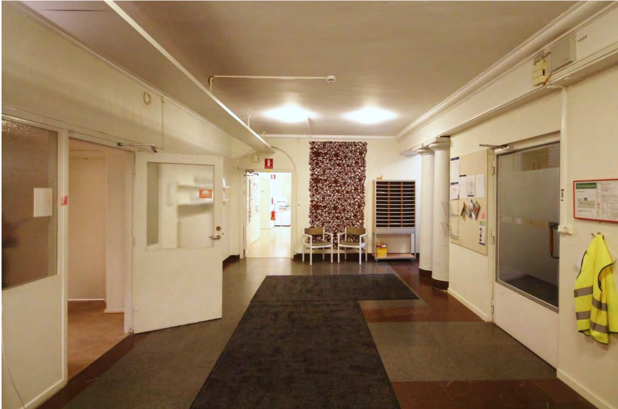
Rum 01.101. Vestibul med originalinslag i form av kalkstensgolv, putsade väggar, välvd dörröppning samt putsat tak med kraftig taklist. Till höger i bild sekundär vägg mot trapphus och till vänster utbytt dörrparti.
