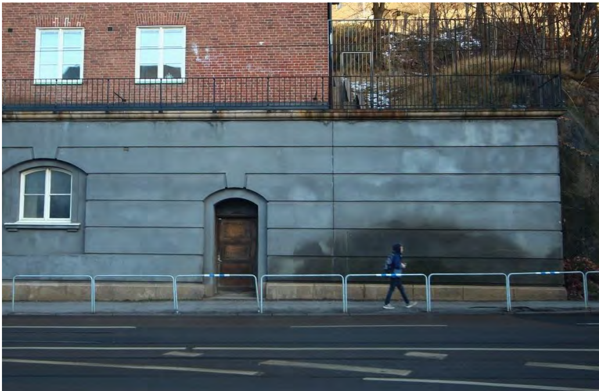
Fuktgenomslag till följd av bristande funktion i dränering. Sockelväningen mot Per Dubbsgatan.
