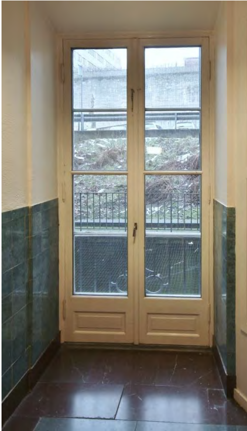
Inåtgående kopplad fönsterdörr i trä med liggande spröjs. Golv och sockel i röd kalksten samt kakelbröstning. Samtliga delar original.
