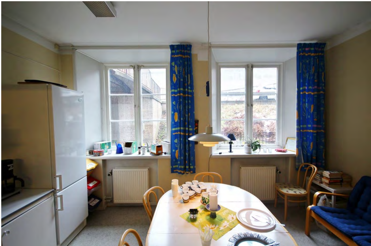
Rum 02.203a. Rumsindelningen härrör från ombyggnaden 1965. Originaldetaljer finns kvar i anslutning till ytterväggen – fönsterbänk, fönsterfoder och fönster.
