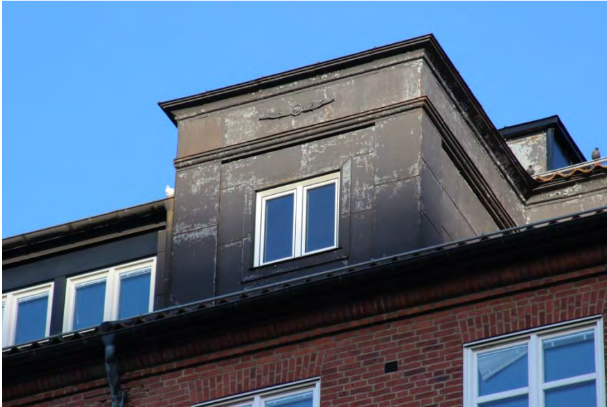
Plåtarbete med färgsläpp.
