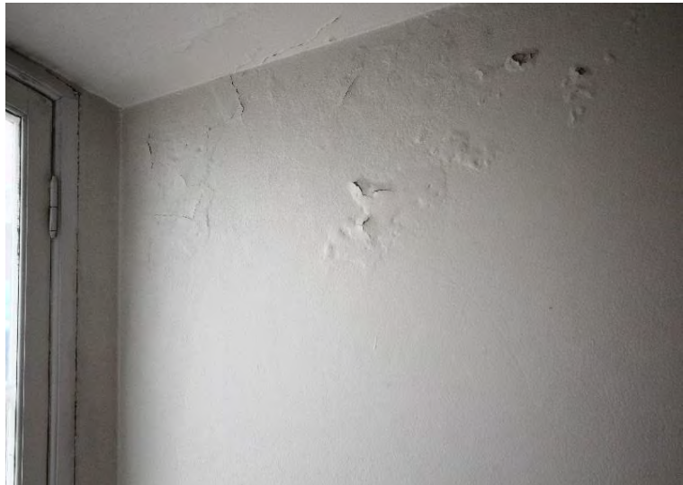
Fuktgenomslag, fönstersmyg mot söder, plan 0.
