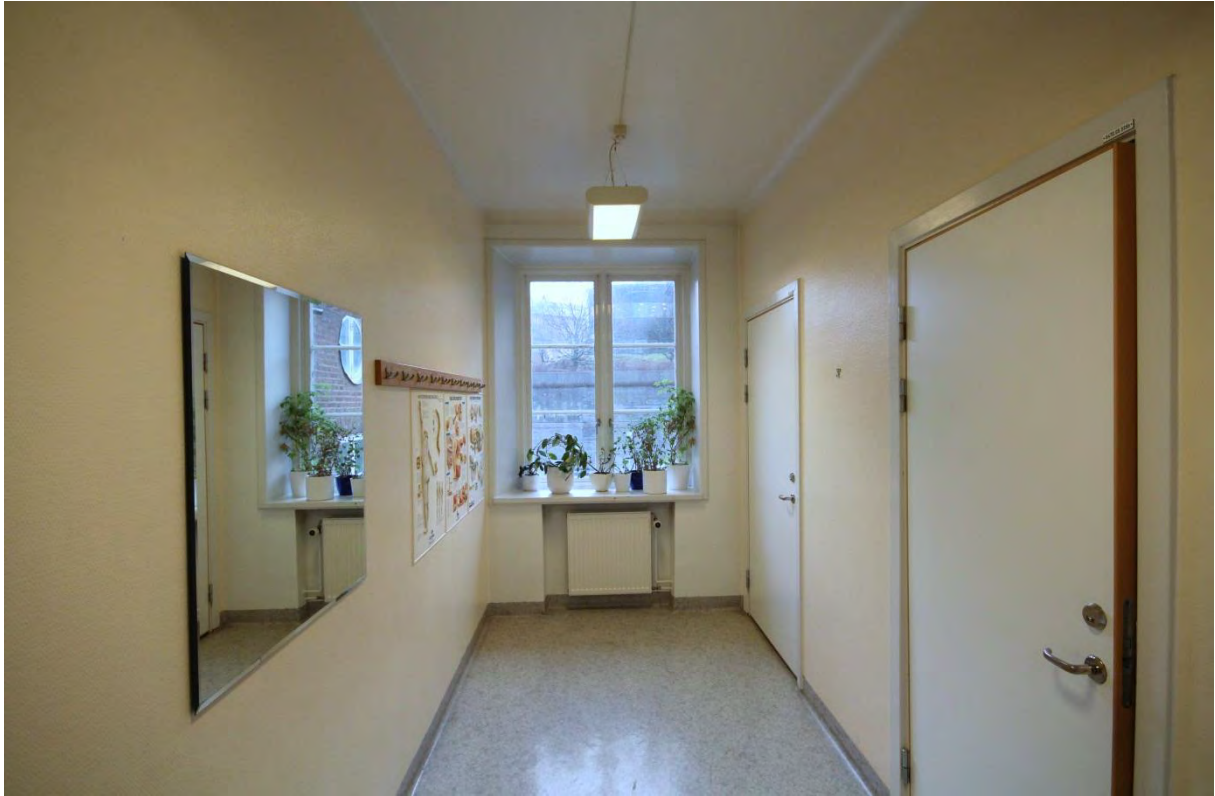
Rum 05.536. Rummet har en senare tillkommen rumsindelning och enstaka bevarade originaldetaljer – fönster, fönsterfoder och fönsterbänk.
