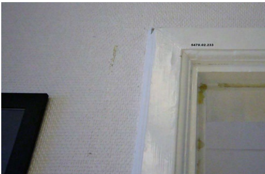
Sprickor och begynnande färgsläpp på snickeridetalj, plan 2. Väggen intill har målad glasfiberväv med synliga fläckar.
