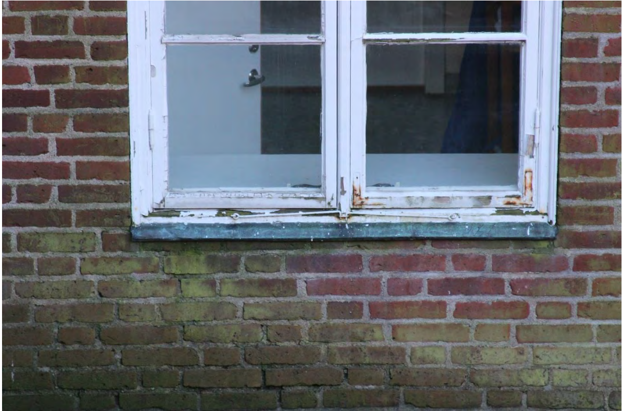
Fasad mot norr. Skadade fogar, påväxt på murverk till följd av förhöjd fukthalt. Fönstret har färg- och kittsläpp, rostade beslag och träskador i fönstrets nederdel. Skador till följd av bristande underhåll.
