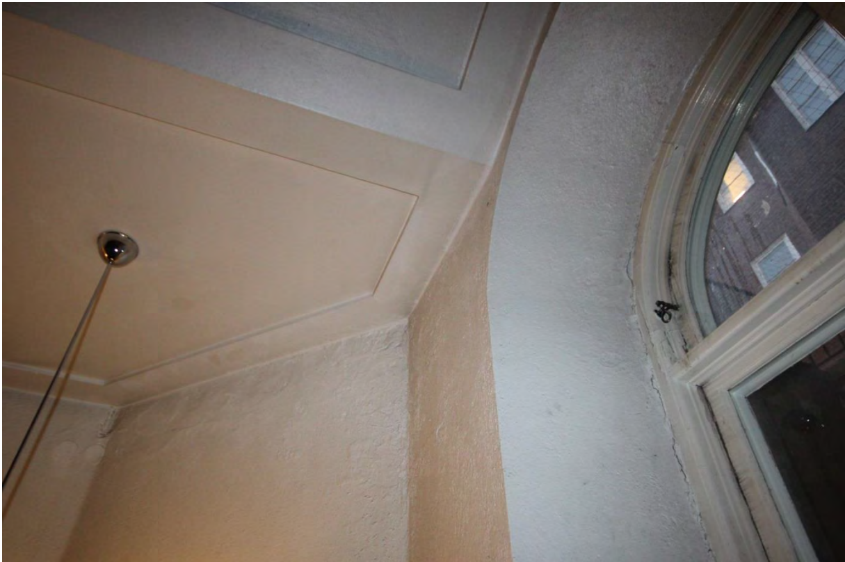
Fuktgenomslag i huvudtrapphus, suterrängvåning, vägg under mark. Sprickor i anslutning till fönsterkarm.
