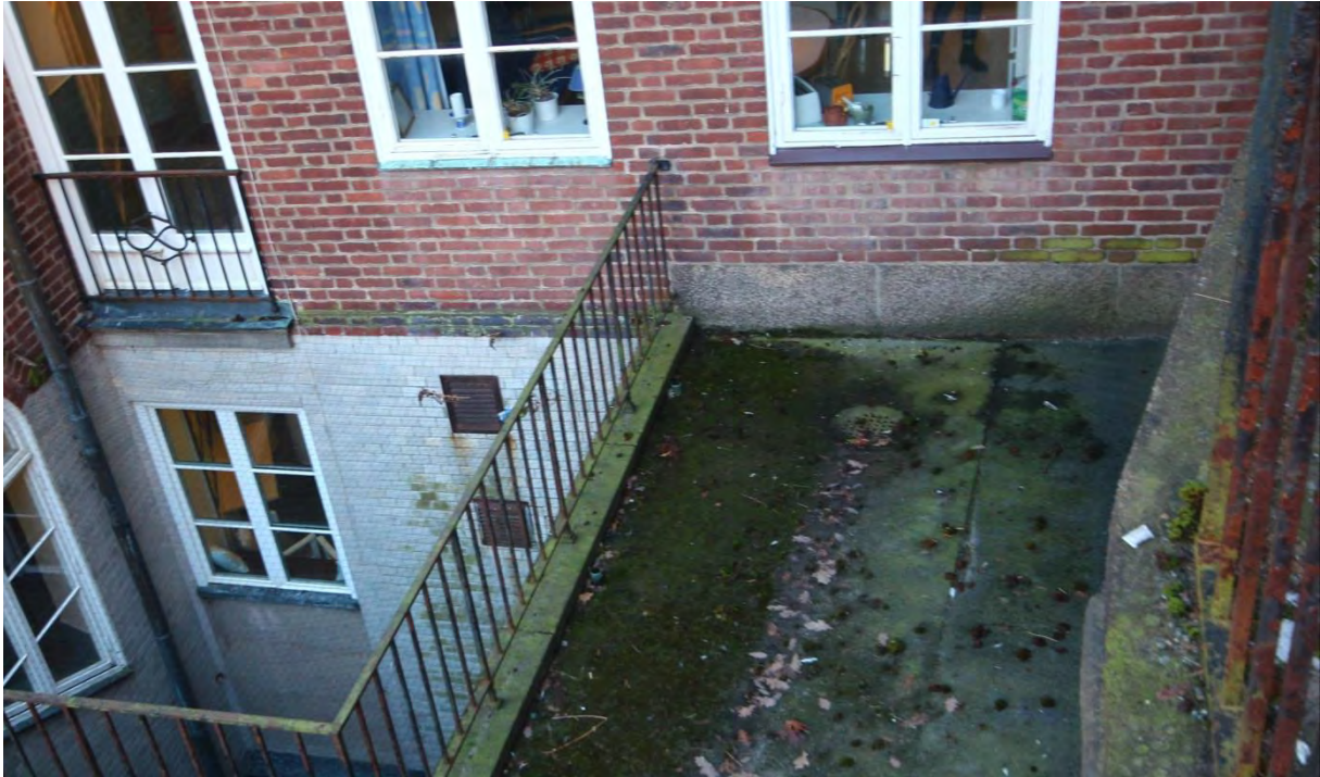
Dagbrunn med bristfällig funktion. Påväxt på mark och delvis på fasad.
